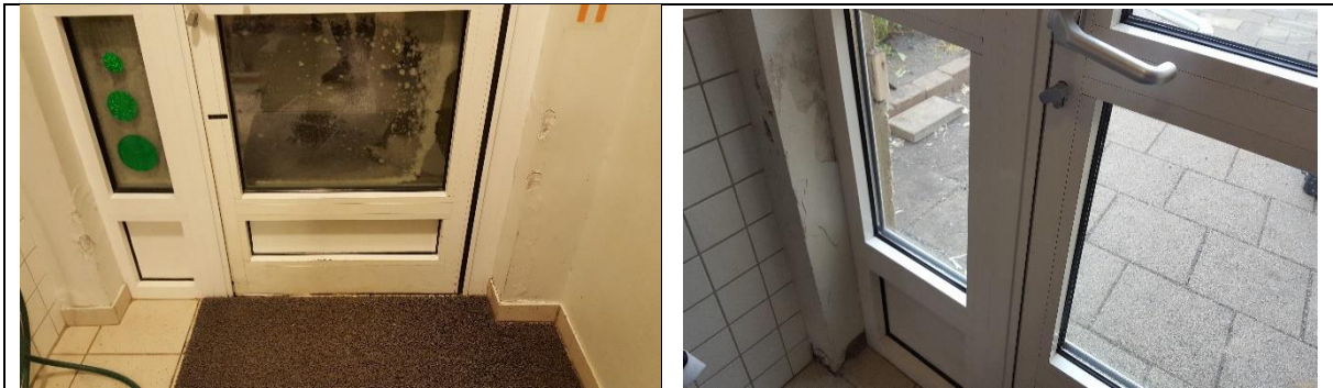
Mynd. Rakaskemmdir við útidyrhurðir.
